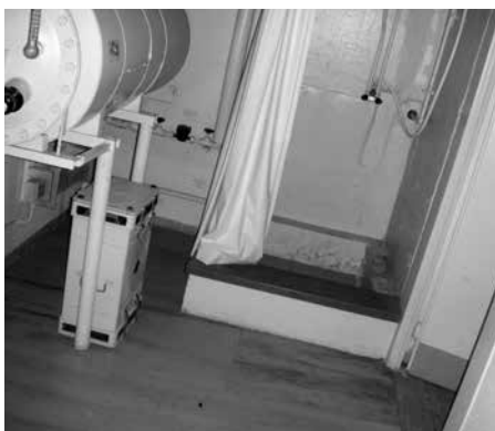
Douche de décontamination
